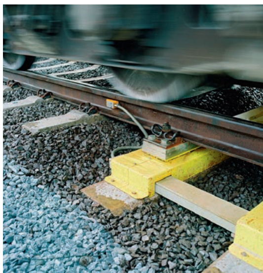
Sensorer på och i anslutning till spår för registrering av data.
