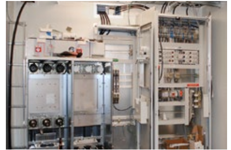
■ Installationer av hög kvalitet anpassade för järnvägssektorn gör anläggningarna säkra och hållbara.
